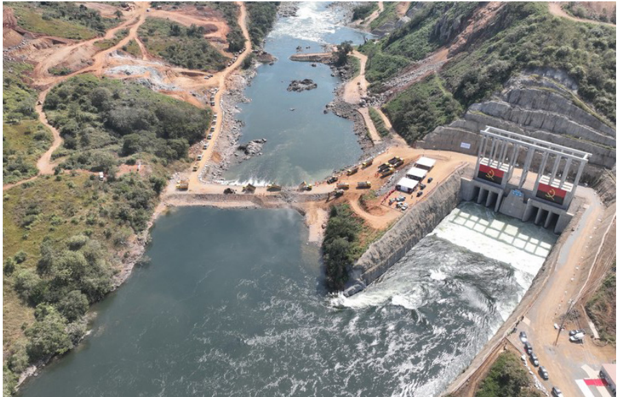
لقطة جوية تظهر مراسم للتحويل المؤقت لمجرى نهر كوانزا في ٢٠ مايو ٢٠٢٣ بموقع محطة كاكولو كباكا لتوليد الطاقة الكهرومائية التي شيدتها شركات صينية في مقاطعة كوانزا نورتي بانغولا. (شينخوا)
